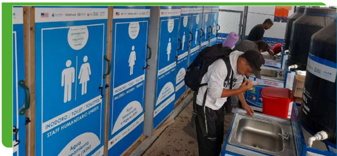
Las personas en tránsito migratorio hacen uso de las instalaciones sanitarias y facilitando el acceso a agua segura (componente WASH) del Consorcio LIFE-Honduras .
